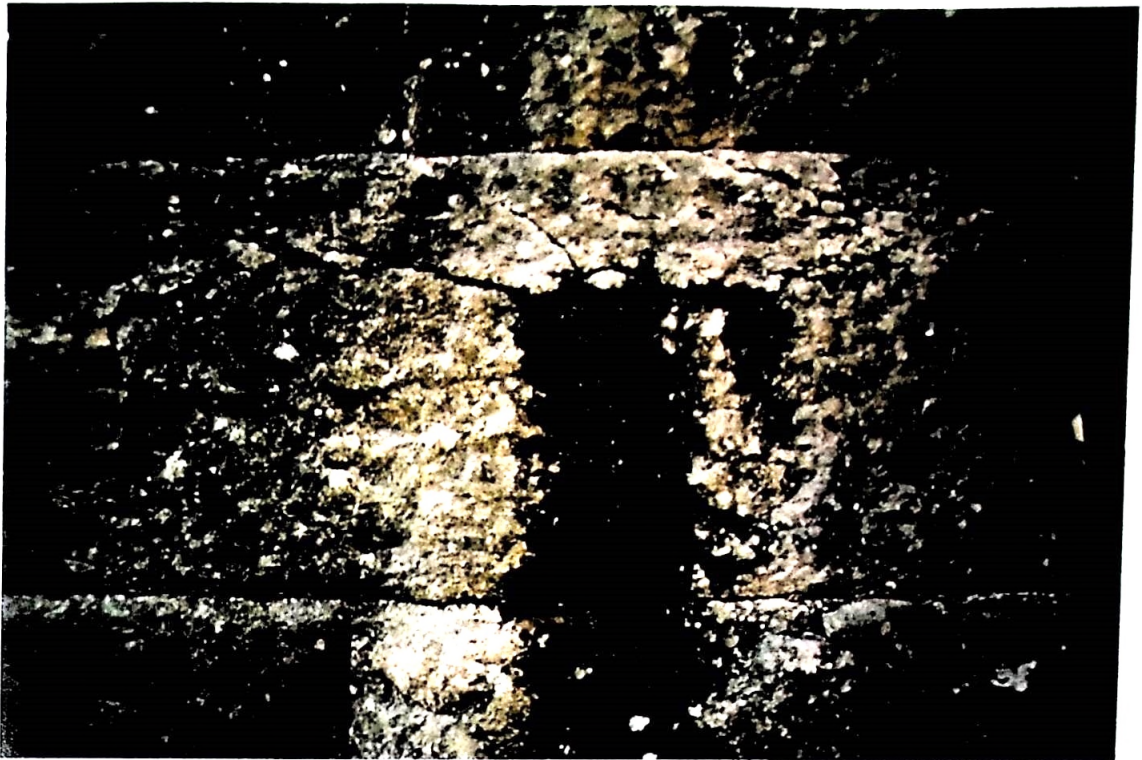
Fig. 33: Suintement d'eau à travers des blocs altérés
